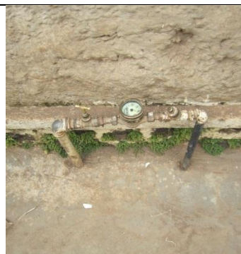
CTO – Arrivée d'eau à relier à la nouvelle plomberie pour remplir le tank
