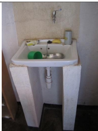
CTO – Point d'eau 3
