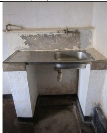
CTO – Point d'eau 2
