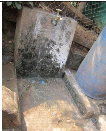
CTO – Point d'eau 1
