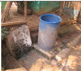
CTO – Point d'eau 1 bis
